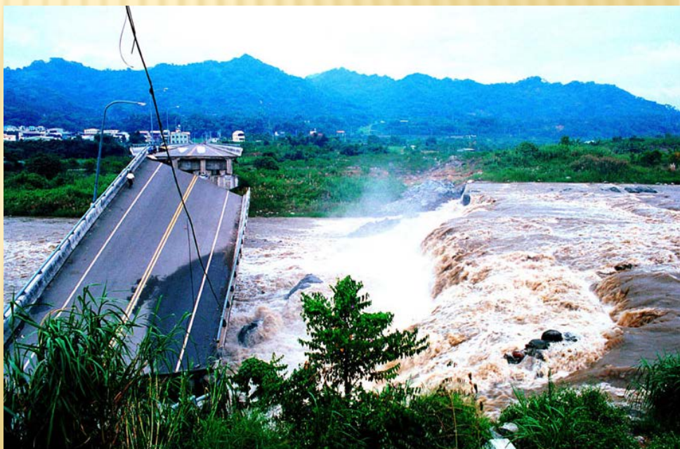
車籠埔斷層在大甲溪河床隆起・埤豐橋塌落中（洪如江攝・民國 880925）
