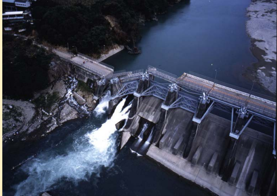
九二一大地震，大甲溪的石岡壩因斷層錯動而破壞（連永旺攝）
